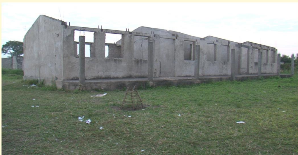
@Hoje em Moçambique: Obras paralisadas, ainda não tem próximos passos para conclusão
