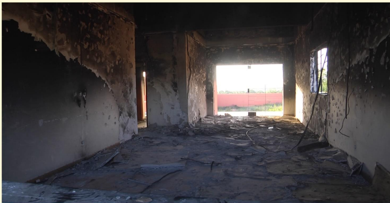
©Hoje em Moçambique: Infra-estruturas afectadas
