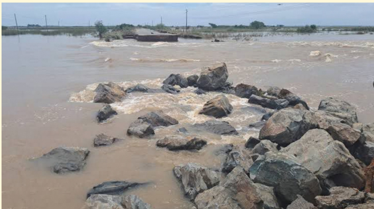
Hoje em Moçambique: Estado actual da Estrada Nacional N1, troço 3 de Fevereiro
